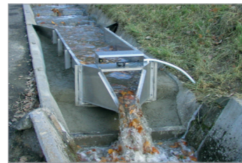
H-Flume zur berührungslosen Abflussmessung über Ultraschallsensoren (Bild: Deponie Langenlonsheim)
