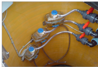
Messschacht mit schichtweiser Sickerwassererfassung und aliquoter Probennahme (Bild: Deponie Profen)
