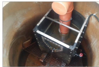
Für stark variable Abflussmengen und chemisch belastete Wasser (Bild: Deponie Wüstendittersdorf)
