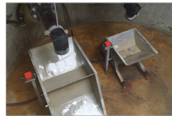
Serviceschacht mit Kippzählern Volumina von 0,1 - 30 l (Bild: Deponie Seehausen)
